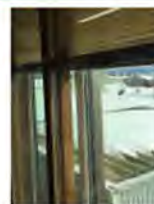
高断熱窓(2層外窓+3層内窓)
